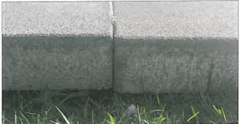
Fot. 5 | Tolerancje wykonania betonowych płyt brukowych
